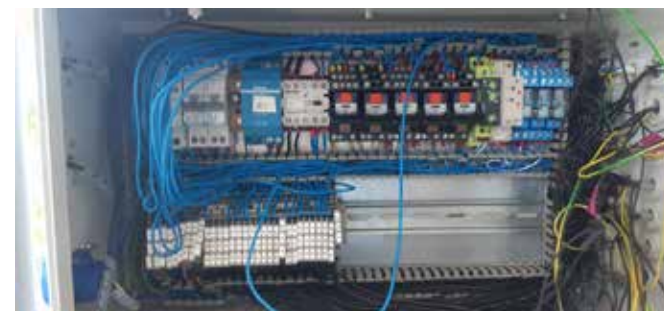
Blick in den Schaltschrank und Verkabelung einer konventionellen Steuerung der Versuchs-Imprägnieranlage am Standort.
